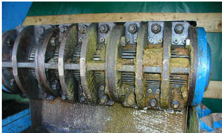
Photo APAD. Cage de machine à barreaux
